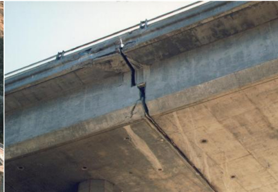
Μετατόπιση του καταστρώματος σε ενδιάμεσο αρμό, I-5/SR14 Interchange.
