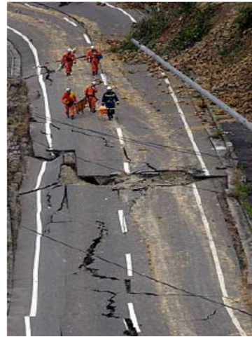
Θραύση οδοστρώματος και αστοχία επιχώματος, σεισμός Niigata-ken Chuetsu, 2004
