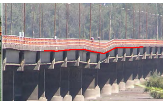
Καθίζηση βάθρου λόγω ρευστοποίησης. Γέφυρα Juan Pablo II, σεισμός Chile (2010).
