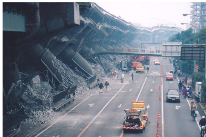
Αστοχία βάθρων, ανεπαρκές μήκος υπερκάλυψης διαμήκους σπλισμού, Fukae, Hansin Expressway, σεισμός Kobe (1995).
