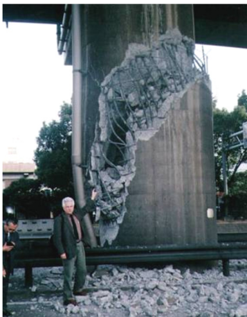
Διατμητική αστοχία βάθρου, Hanshin Expressway, σεισμός Kobe (1995).
