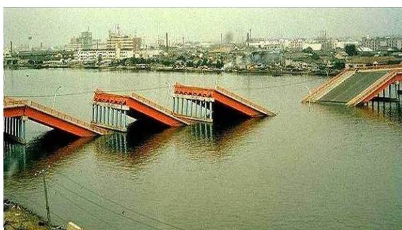
Αστοχία λόγω ρευστοποίησης. Γέφυρα Showa, σεισμός Niigata (1964).
