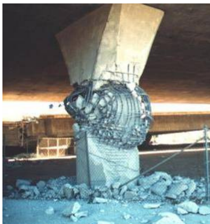
Διατμητική αστοχία και δημιουργία πλαστικής άρθρωσης, Mission Gothic Undercrossing, σεισμός Northridge (1994).
