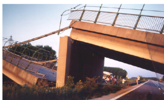
Αστοχία λόγω διάρρηξης ρήγματος. Γέφυρα Arifiye, σεισμός Kocaeli (1999).
