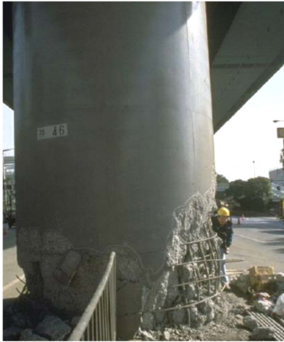
Αστοχία βάθρου λόγω κάμψης, σεισμός Kobe (1995).
