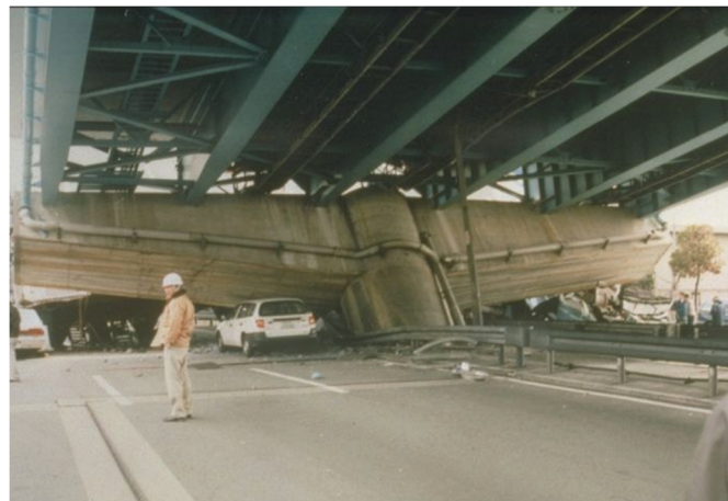
Διατμητική αστοχία βάθρου, Takashio Viaduct, Route 3, σεισμός Kobe (1995).
