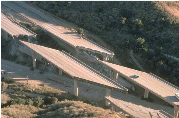
Ανατροπή του καταστρώματος, Gavin Canyon Undercrossing.
