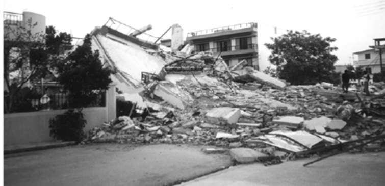
Κατάρρευση 5-όροφης οικοδομής, σεισμός Πάρνηθας 1999.
