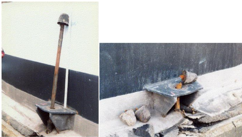
Σχήμα 35: Αστοχία στην αγκύρωση της δεξαμενής.
