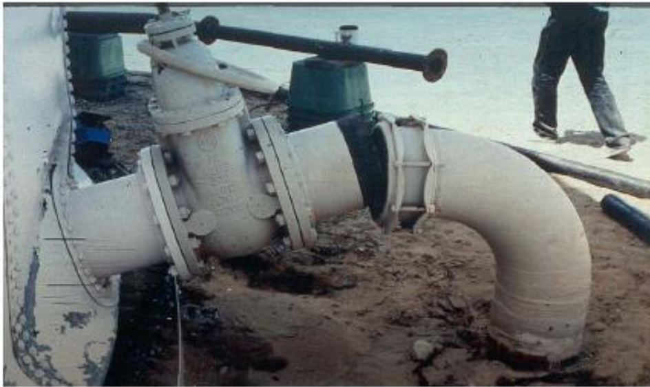
Σχήμα 34: Αστοχία σε ακροφύσιο.
