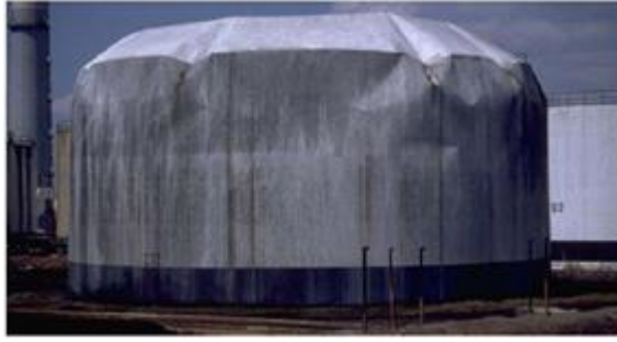
Σχήμα 33: Αστοχία λόγω κυματισμού του υγρού στο άνω τμήμα του κελύφους της δεξαμενής.
