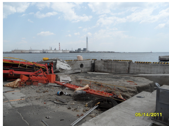
Σχήμα 2.6. Σημαντική κατακόρυφη καθίζηση πίσω από κρηπιδότοιχο κατά τη διάρκεια του σεισμού του Tohoku (Great East Japan) το 2011 (Percher 2014).
