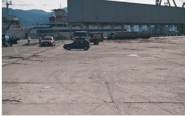
Σχήμα 2.7. Καθίζηση του επιχώματος στο λιμάνι της Derince κατά την διάρκεια του σεισμού του Izmit (Kocaeli) το 1999.
