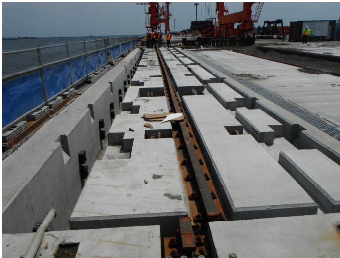
Σχήμα 2.24. Μετακίνηση παράκτιων σεισμικά μονομένων σιδηροτροχιών γεραμών κατά τη διάρκεια του σεισμού του Tohoku (Great East Japan) το 2011 (Percher 2014).
