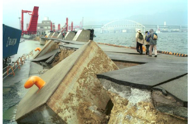
Σχήμα 2.4. Ανατροπή και εκτεταμένη κλίση κρηπιδότοιχων κατά τη διάρκεια του σεισμού του Hyogo-ken Nanbu (Kobe) το 1995.
