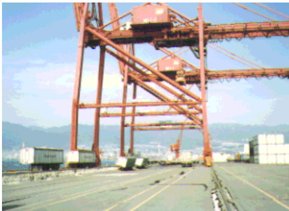
Σχήμα 2.20. Η θεμελίωση σιδηροτροχιών έδρασης του γερανού υπέστη πλευρική μετακίνηση προς την θάλασσα και σημειώθηκε καθίζηση του εδάφους μεταξύ των σιδηροτροχιών [Σεισμός του Hyogo-ken Nanbu (Kobe) το 1995, Rokko Island].
