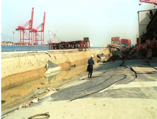
Σχήμα 2.3. Ιδιαίτερα εκτεταμένες καθιζήσεις του επιχώματος πίσω από κρηπιδότοιχους κατά τη διάρκεια του σεισμού του Hyogo-ken Nanbu (Kobe) το 1995.
