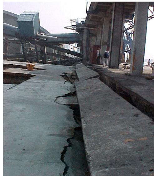
Σχήμα 2.2. Καθίζηση πίσω από κρηπιδότοιχο διατομής κιβωτίου που υπέστη πλευρική μετακίνηση στο λιμάνι Taichung κατά τη διάρκεια του σεισμού του Chi-Chi το 1999.
