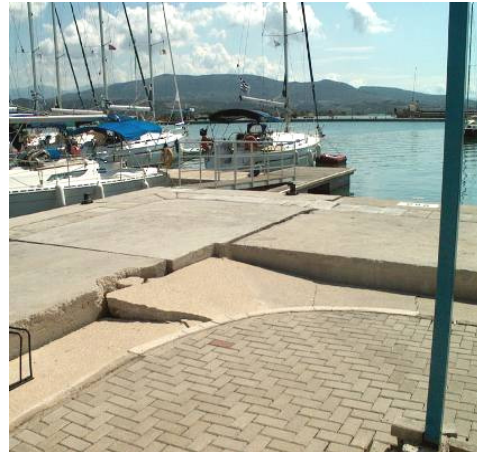
Σχήμα 2.19. Καθίζηση του επιχώματος (25cm), ολίσθηση προς την θάλασσα και κλίση των κρηπιδότοιχων στην περιοχή της Μαρίνας κατά την διάρκεια του σεισμού της Λευκάδας το 2003.
