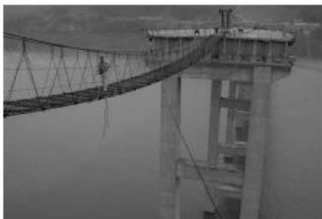
Ακραίο άνοιγμα στο οποίο σημειώθηκε η κατάρρευση
